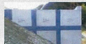
ボックスカルバート外側のジョイントシール
