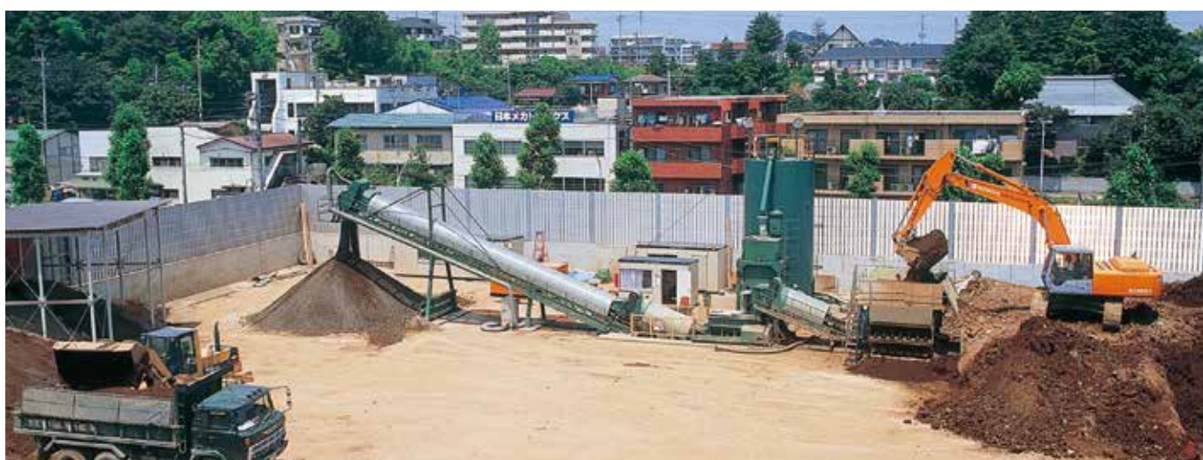
建設発生土改良プラント
