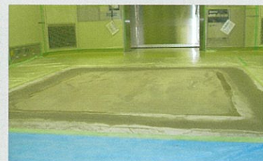
病院手術室(耐荷重シート下地)
