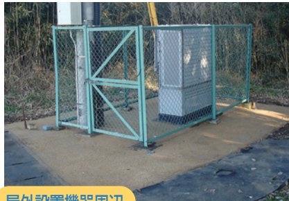
屋外設置機器周辺
